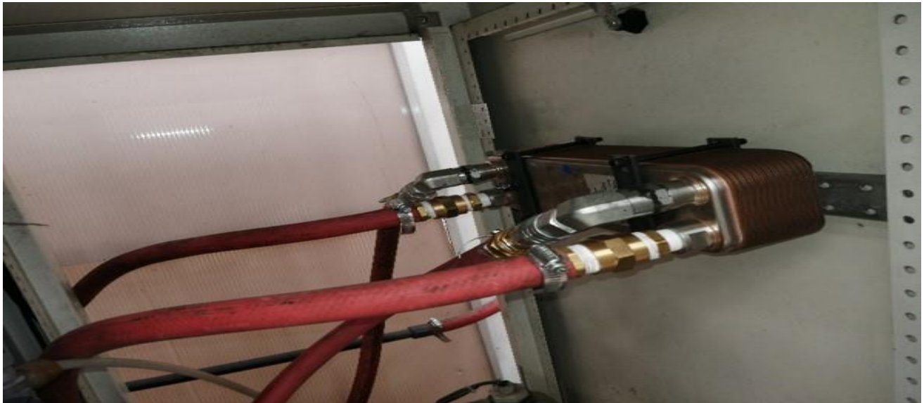
Ilustración 11 intercambiador instalado y funcionando
