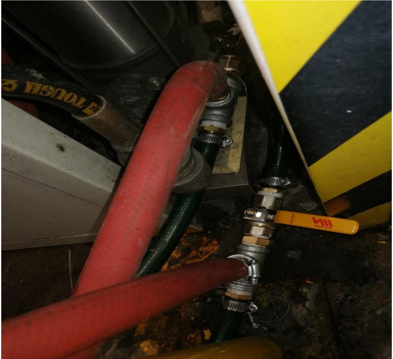
Ilustración 9 manguera y llaves de paso
